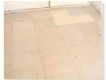
例) 石綿含有ビニル床タイル
