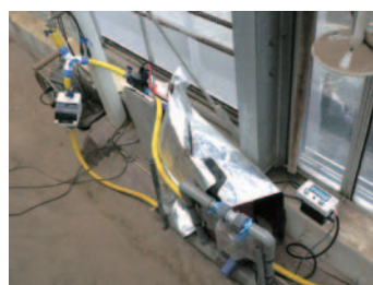
簡易な給肥・給水システム
