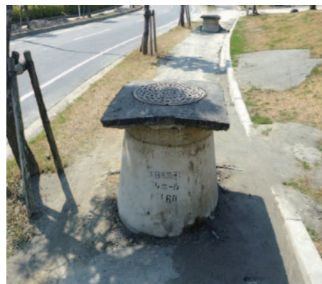
液状化によるマンホールの浮上状況 (東日本大震災、2011年3月11日)
