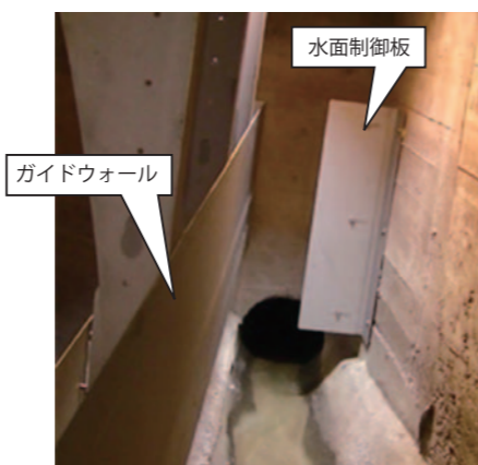
水面制御装置の設置状況 (ドイツの事例)
