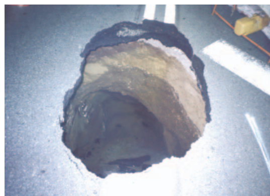
発見された道路下の空洞
