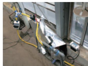
簡易な給肥・給水システム
