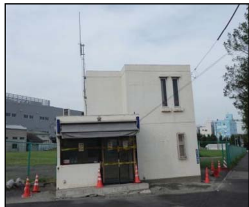
液状化で傾いた建物
