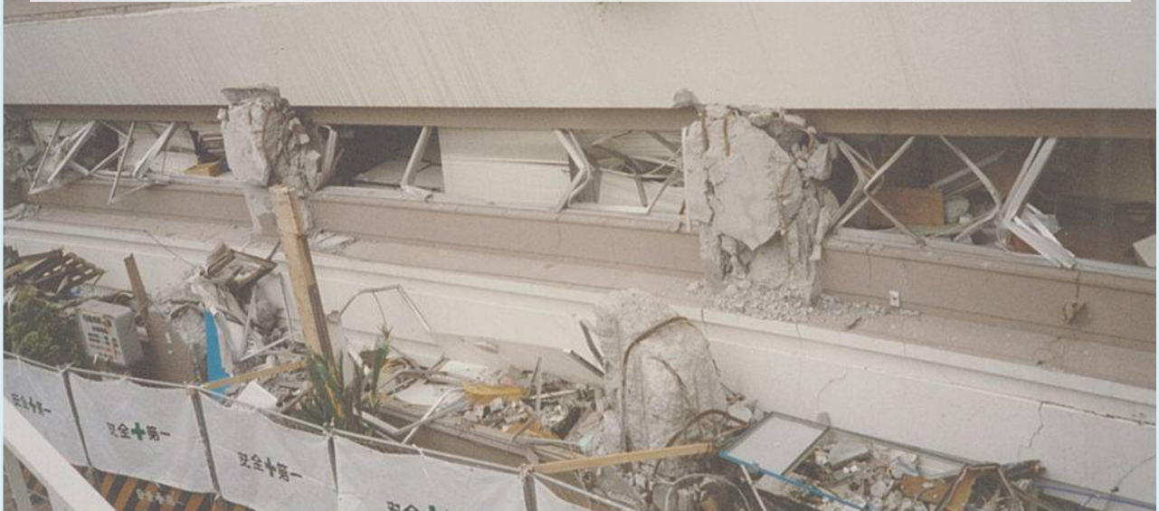
阪神・淡路大震災により被災した建物
