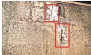
擁壁のコンクリート剥離・鉄筋腐食
