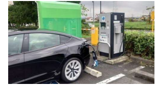
急速充電器を設置した駐車場（舎人公園駐車場）
