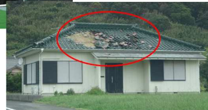
↓台風15号による瓦屋根被害 出典：「令和元年房総半島台風を踏まえた建築物の強風対策の方向性」国交省
