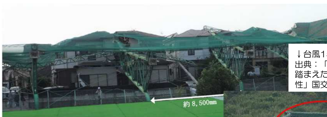
↑台風15号によるゴルフ練習場鉄柱の転倒状況 出典：「令和元年台風第15号及び第19号に伴う強風によるゴルフ練習場のゴルフ練習場の鉄柱の被害現地調査報告 調査報告」国交省
