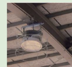
写真15 照明器具・懸垂物の例
