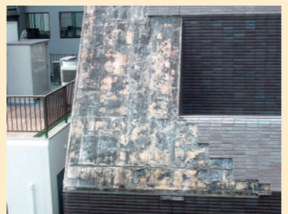
写真6 タイル面の剥落
