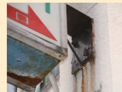
写真11 支持金物が腐食した状態
