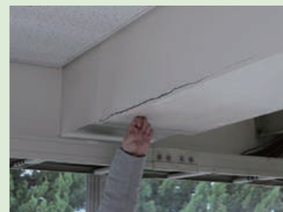
写真13 梁仕上げ材のひび割れ
