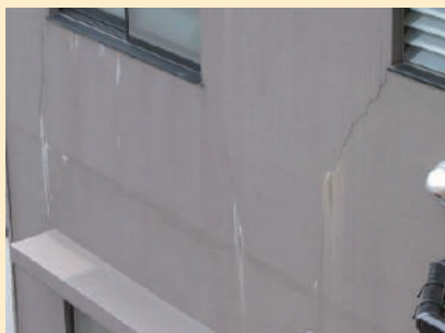
写真1 ひび割れや白華の発生
