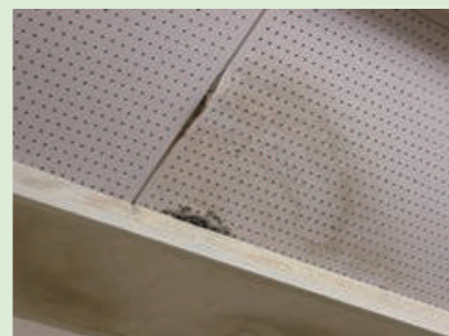
写真12 天井仕上げ材のしみ・破損
