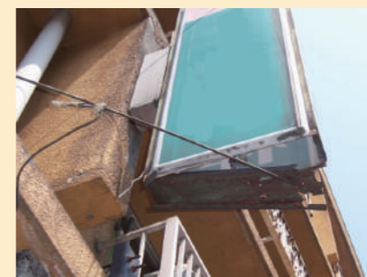
写真10 看板底板が腐食した状態
