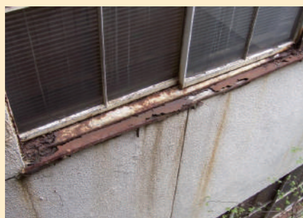
写真7 サッシの腐食
