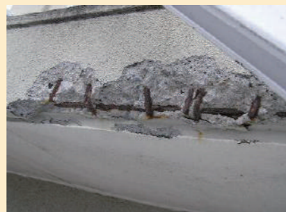
写真3 欠損による鉄筋の露出
