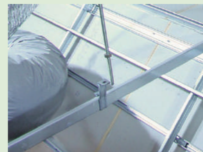
写真14 天井材の外れ
