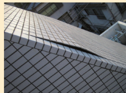
写真5 タイル面の浮き
