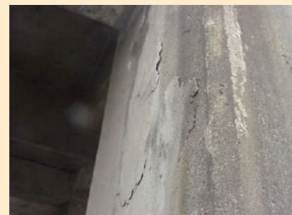
写真2 コンクリートの剥離
