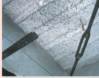
例) 石綿含有吹付けロックウール
