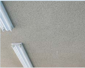
■天井材 例) 石綿含有吹付けパーミキュライト
