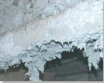
例) 吹付けアスベスト(青石綿)
