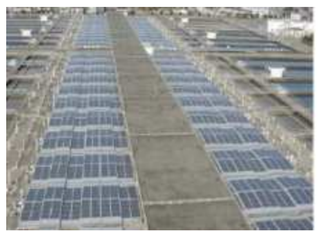
出典:「東京都長期ビジョン」(平成26年12月/東京都) 再生可能エネルギーの利用拡大に向けた取組 (朝霞浄水場における大規模太陽光発電)
