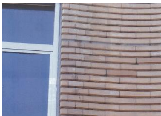
修復箇所のクラック（届出資料より）
