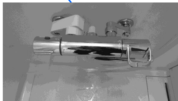
e サーモスタット式水栓金具の設置例 (やけど防止カバー付き)
