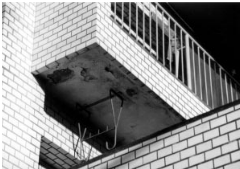
バルコニーの下部に見られる塗装の浮きとはがれ（黒く見える部分）
