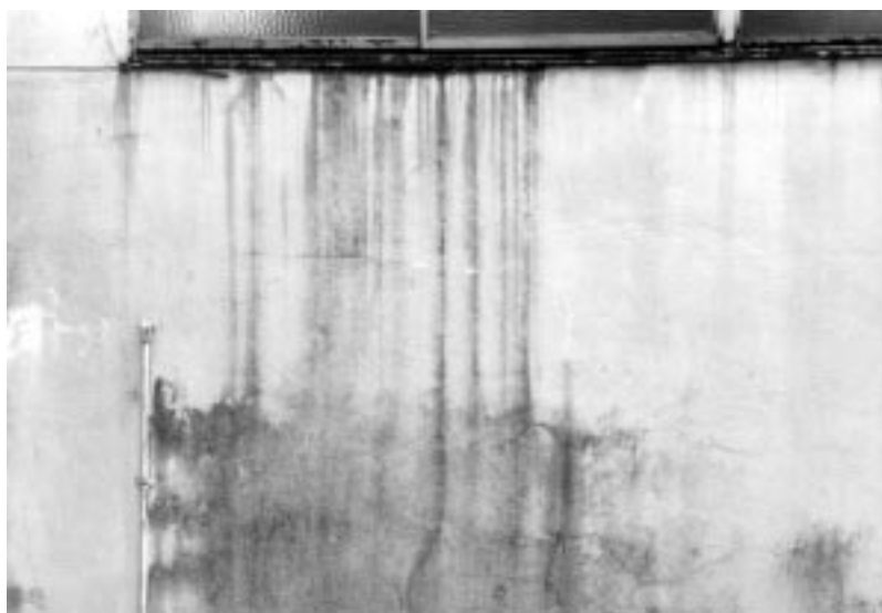
よごれが相当見られる外壁。ひび割れも見られます。
