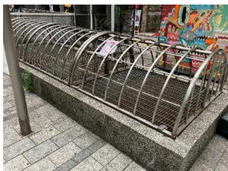
写真 3 地上の換気口（排気口） (新宿サブナード)
