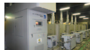
マイクロガスタービン発電機
