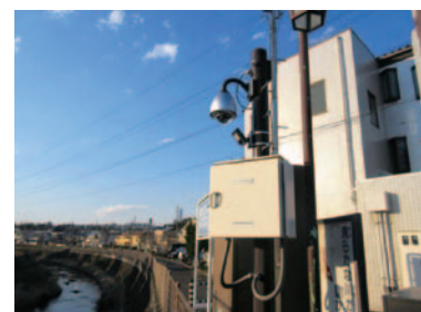
河川水位監視カメラ
