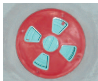
マンホールに設置した弁 (マンホールの内側から撮影)
