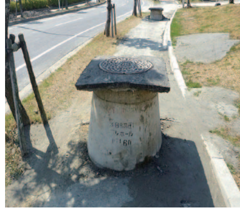
液状化によるマンホールの浮上状況 (東日本大震災、2011年3月11日)
