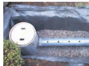
浸透トレンチ
