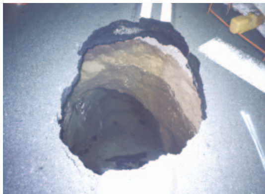
発見された道路下の空洞
