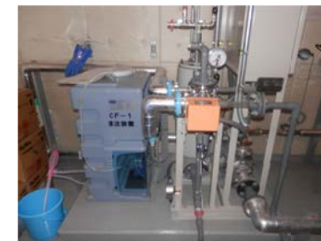
写真② ろ過装置及び塩素注入装置
