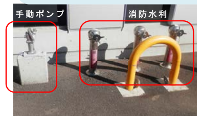
写真④ 雨水利用の消防水利と手動ポンプ
