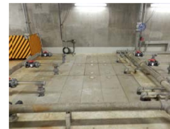
写真② ばっ気槽（膜処理）
