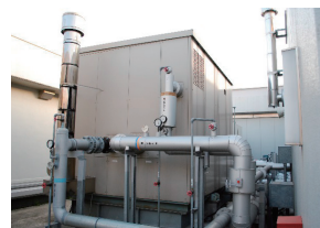
▼ コジェネレーションシステム 排熱利用冷凍機
