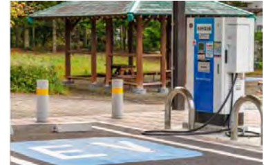
EV充電スタンド
