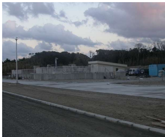
写真 5-1 新島村本村水処理センターの水処理施設
