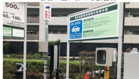
都営住宅における設置例
