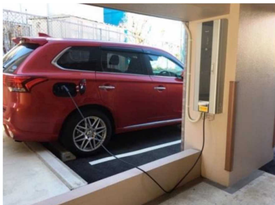
図 2-53 集合住宅における充電設備設置例
