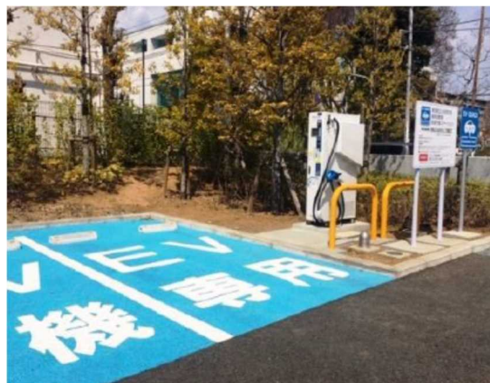
図 2-54 都有施設（立川合同庁舎）における充電器設置例
