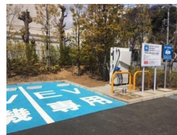
急速充電器（立川合同庁舎）
