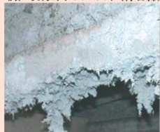
例) 吹付けアスベスト(青石綿)
