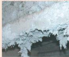
例) 吹付けアスベスト(青石綿)
