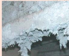
例) 吹付けアスベスト(青石綿)
