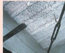
例) 石綿含有吹付けロックウール
