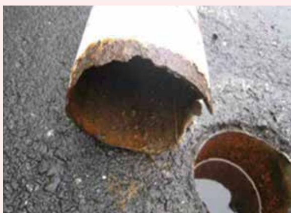
ポールの根腐れによる倒壊
