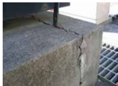
看板基礎のひび割れ
