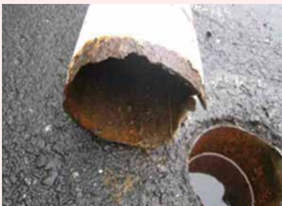
ポールの根腐れによる倒壊
