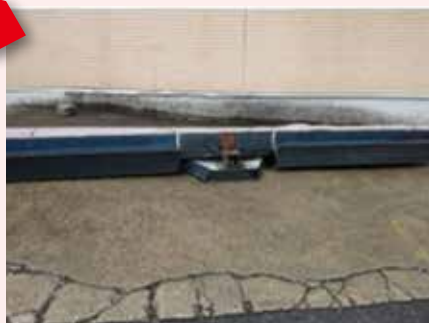
落下した欄間看板
