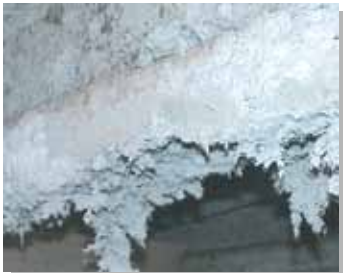
例) 吹付けアスベスト(青石綿)
