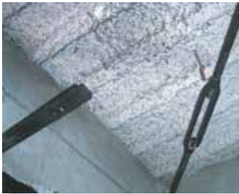
例) 石綿含有吹付けロックウール
