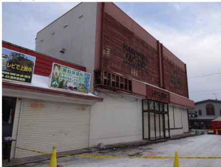
外壁落下後の建物写真①
