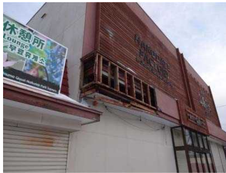
外壁落下後の建物写真②
