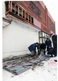
落下した外壁
