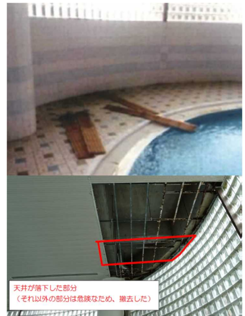
■事故状況 (写真)
