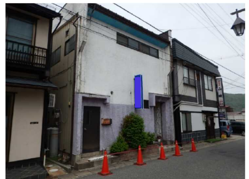
外壁落下建物全景
