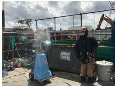
ミスト送風機の設置
