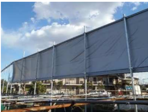
農薬飛散防止施設
