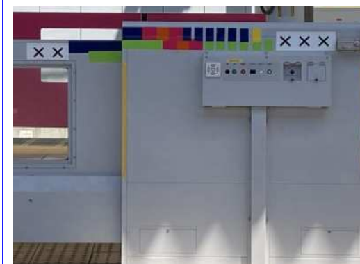
飛田給駅 (FD筐体に設置)
