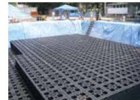
雨水貯留槽・校庭貯留
