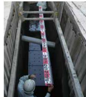
道路下の雨水貯留浸透施設
