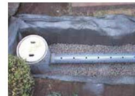
雨水浸透トレンチ
