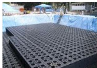
一次貯留施設 (校庭貯留)
