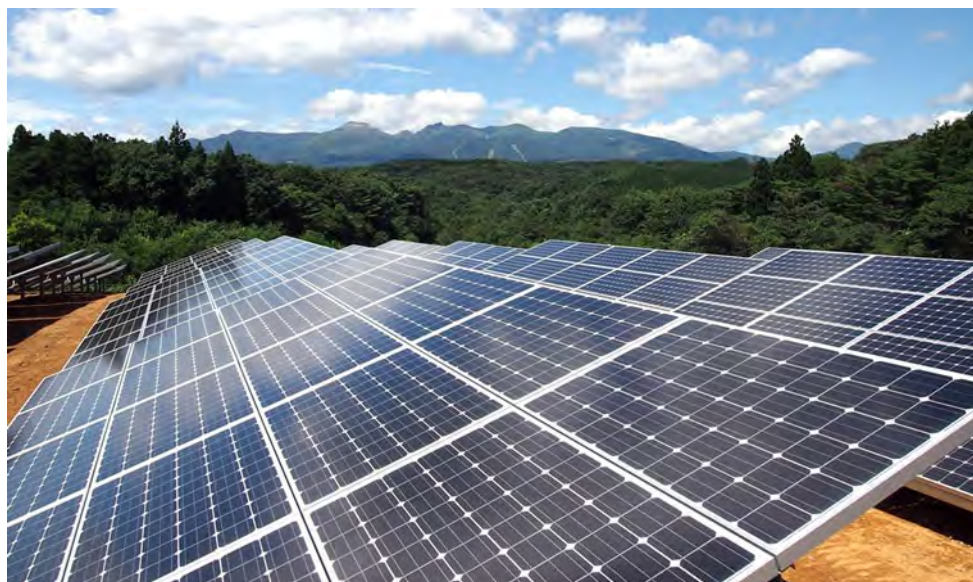
（出典）鹿島建設ホームページ（再生可能エネルギー（太陽光発電））
