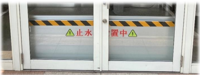
< 設置後（店舗外から） >
