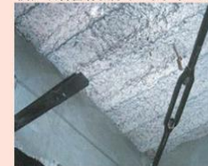
例) 石綿含有吹付けロックウール
