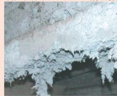
例) 吹付けアスベスト(青石綿)
