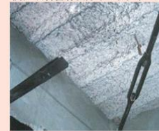
例) 石綿含有吹付けロックウール
