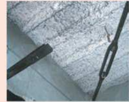
例) 石綿含有吹付けロックウール
