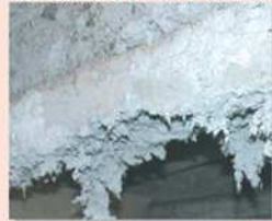
例) 吹付けアスベスト(青石綿)
