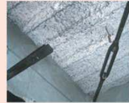
例) 石綿含有吹付けロックウール
