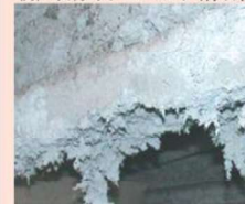
例) 吹付けアスベスト(青石綿)
