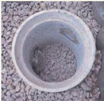
写真 雨水浸透ます
