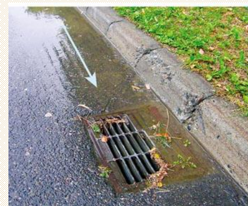
写真 雨水ますへの雨水排水の流入
