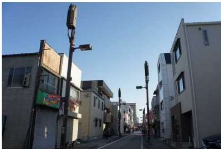
（街路灯との共用柱にトランスを設置した例（ソフト地中化））
